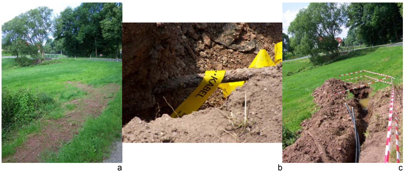
Abb. 61: Abgekürzte Kabelwege durch die Aue
